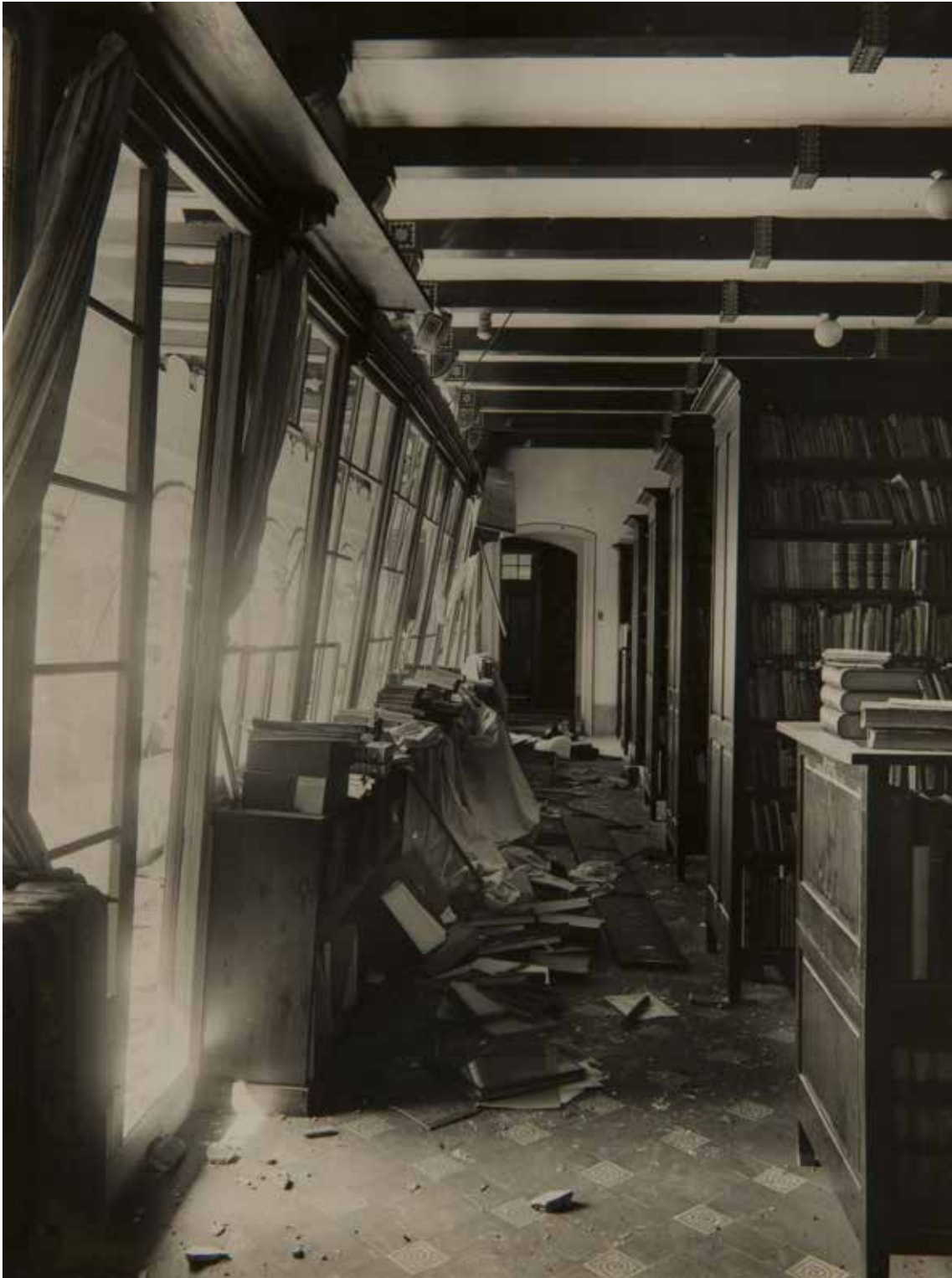
Fig. 4. Destrosses a la galeria de la tercera planta de l'Arxiu a causa dels bombardeigs de l'any 1938. AFB_C_015_112. Autor desconegut.
